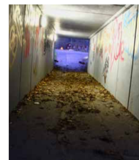
"Konstruktionen på tunneln har sina brister", skriver teknik- och fastighetsförvaltningen.
